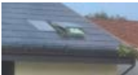
Dachflächenfenster mit Solaranlagen
