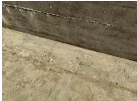
Bild 25: Risse vertikal in Rinne und Arbeitsfuge
