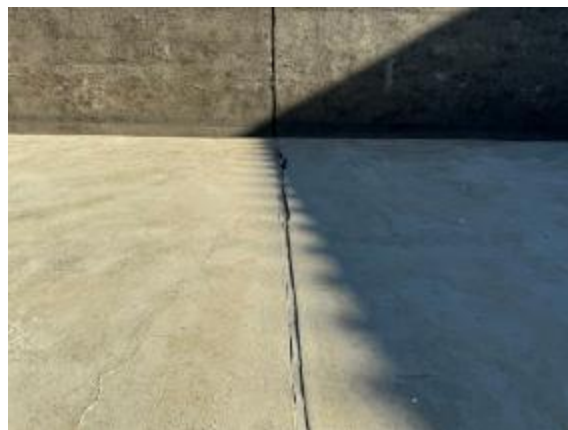
Bild 26: sprödes Fugenmaterial mit Ablösung an Flanken und Ausbruch
