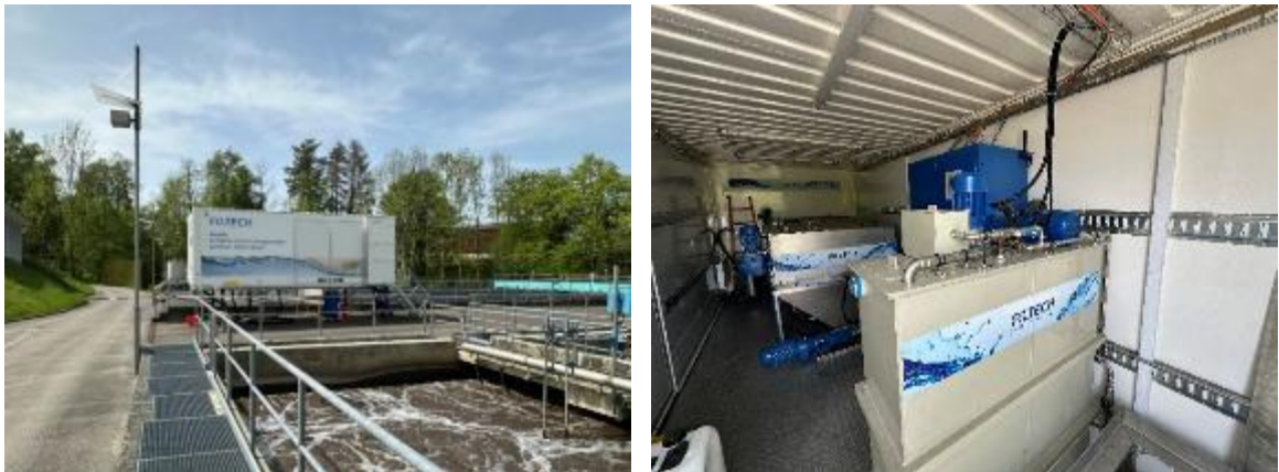
Bild 22: Mobile Schlammeindickungsanlage der Firma Filtech
