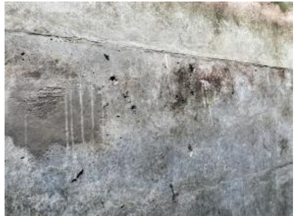
Bild 29: Lunker in Beckenwand
