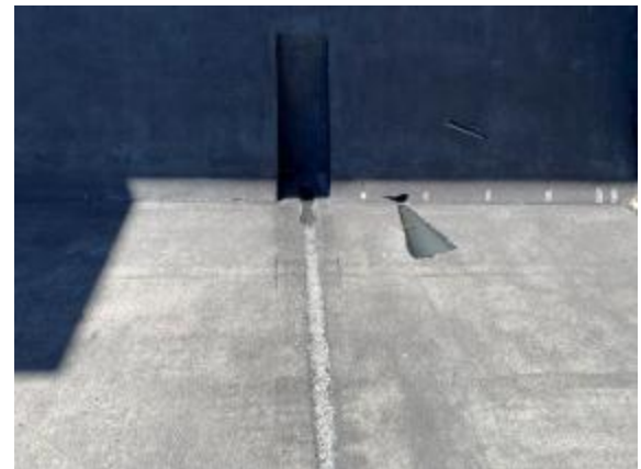
Bild 31: Einkerbung an Voute zu Trennwand und Abriebspuren von Räumler
