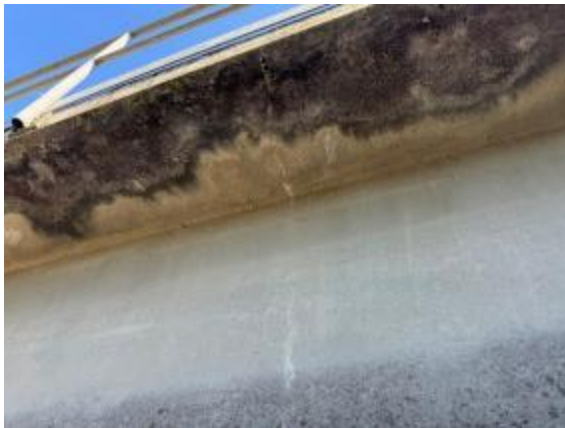
Bild 24: versinterte Risse an den Wänden und Untersicht Beckenkrone
