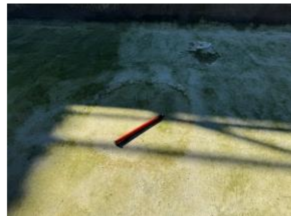
Bild 27: Abplatzungen der Beschichtung an Boden
