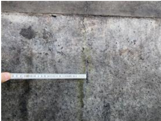
Bild 28: Risse mit kleineren Ausbrüchen an Wand zu RB
