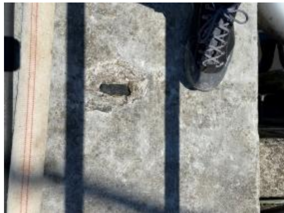
Bild 30: Abplatzung auf Beckenkronen (Laufweg Räumler)
